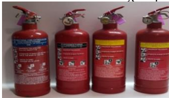
Εικόνα 1. Πυροσβεστήρες με ετικέτες κατασβεστικών υλικών
